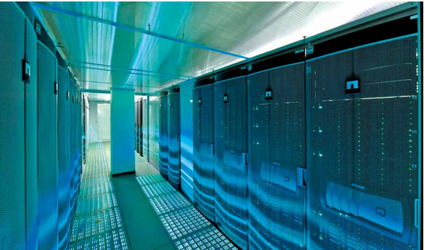
Server-Center von SAP in St. Leon-Rot
